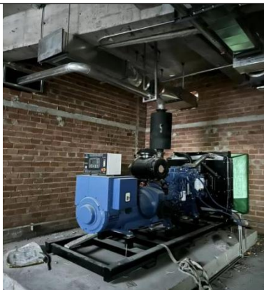
建筑隔声（设备位于设备房内）
