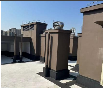
厨房及商业烟道排口
