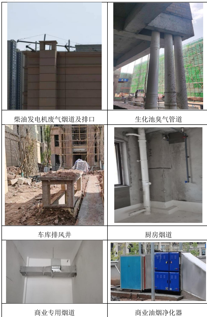
图 3.2 废气处理设施
