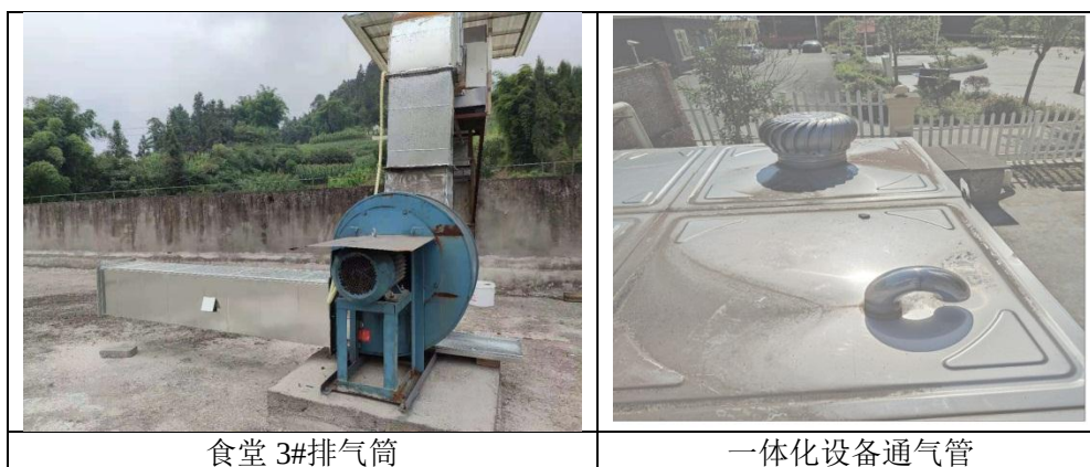
图 4.2 废气处理设施
