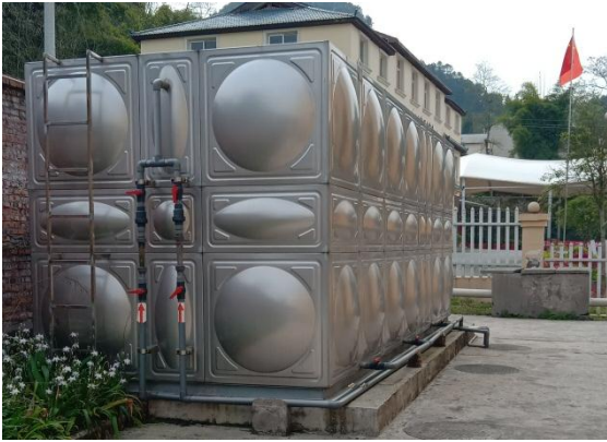
图 4.1 (b) 一体化污水处理设备
