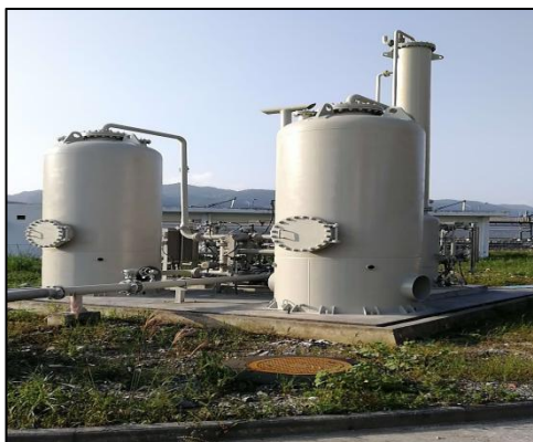
油气回收装置
