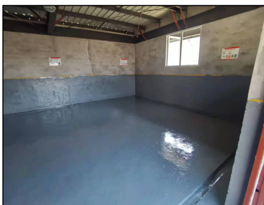
危废暂存间图
