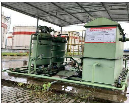
油污水处理装置
