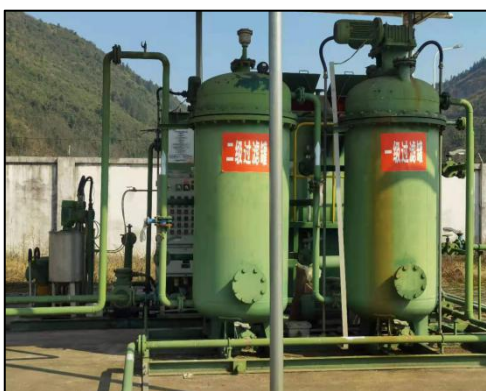
处理设施标志、标牌
